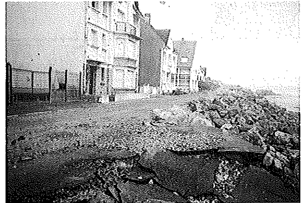
Le revêtement bitumé de la promenade a également « éclaté ». Ce terme est utilisé par la presse locale qui dit même « a explosé sous les vagues » montrant bien que la dalle de béton a cédé sous l'effet d'une poussée interne.
