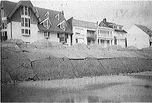
Mars 2002 : toutes les dalles ont été poussées et fracturées par le milieu sur une ligne régulière peu de temps après l'achèvement du travail.
